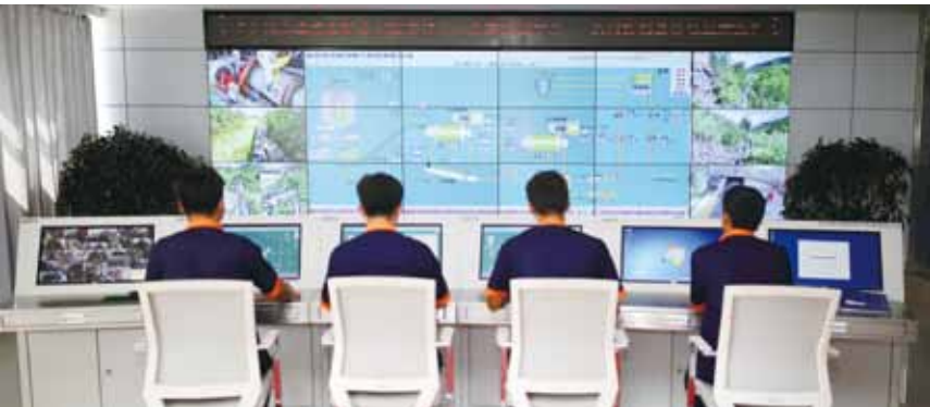
排山楼公司自动化主控室。
